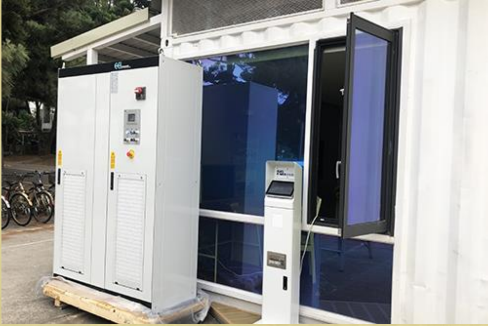
傑明新能源公司提供中央大學義大利 EEI 公司原廠 270 千瓦高功率 PCS 電力調變系統設備，豐富研究資源，嘉惠學子。照片傑明新能源提供
